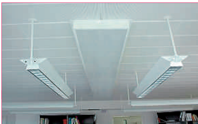
Bürokühlung bei geringstem Deckenhohlraum.
