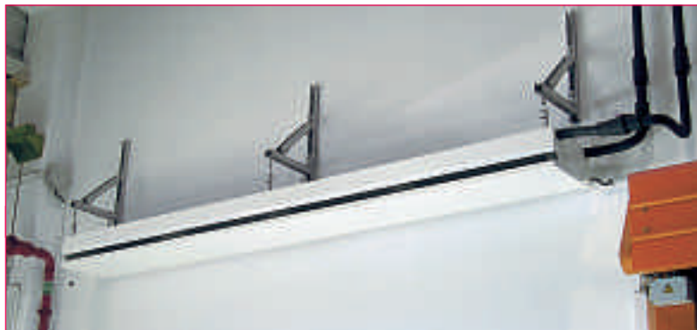
Industriekühlung in einem Medizin-Logistikzentrum.
