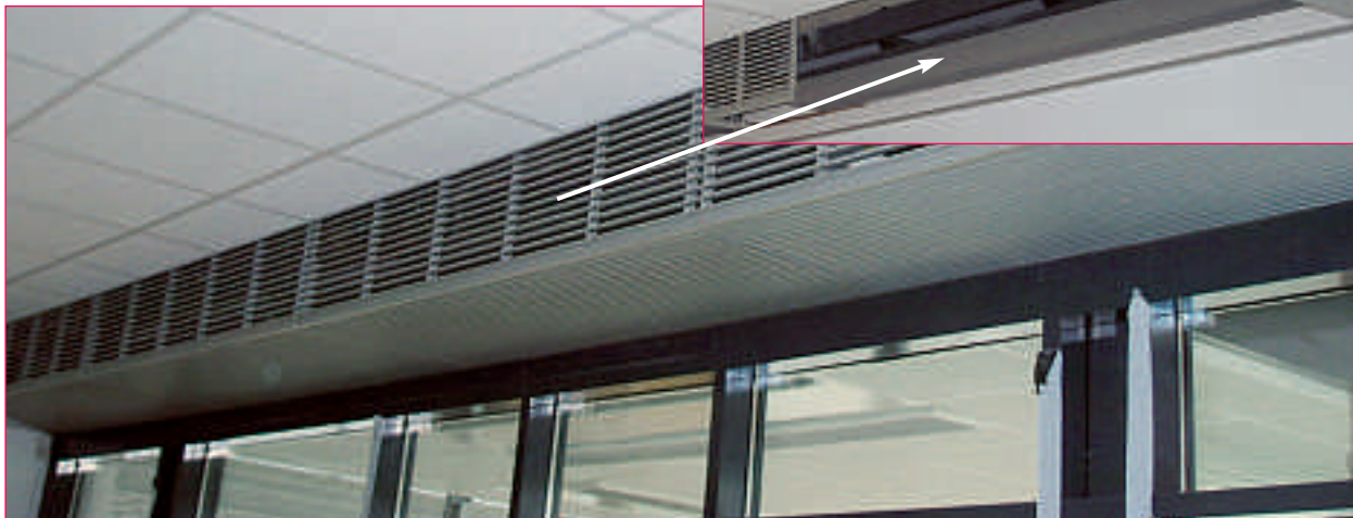
Kühlkonvektoren zur Kühlung und Entfeuchtung integriert im Randfries.
